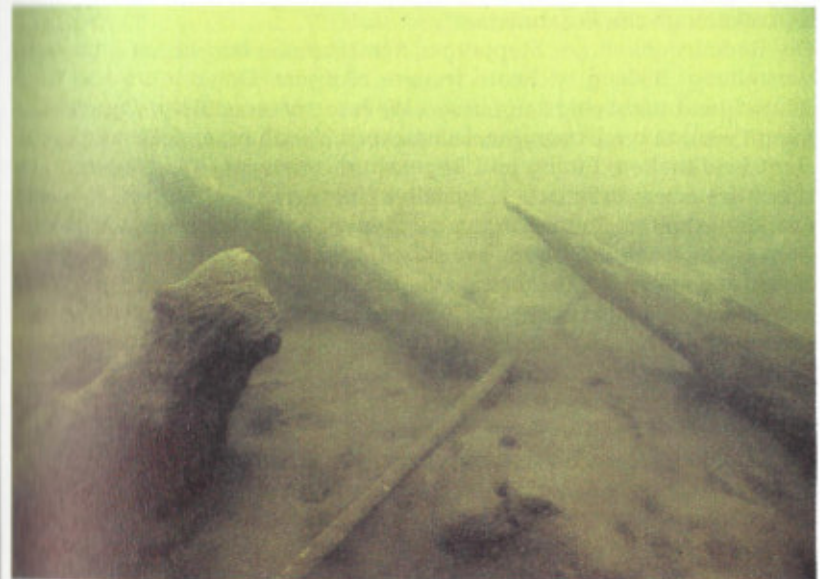
Abb. 22: Unterwasseraufnahmen von Pfeiler 6. Oben: Balkenwand L29 und der anliegende Pfahl P4. Unten: spitz aberodierte Balken eines Querriegels.
