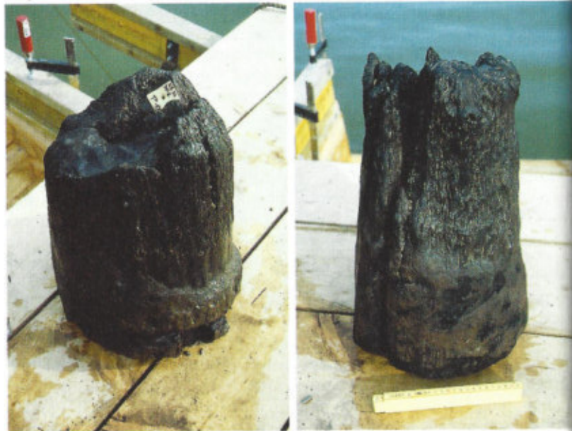
Abb. 18 und 19: Abgesägte Pfahlköpfe (P13, P32) von Pfeiler 6 mit deutlichen Erosionsspuren.
